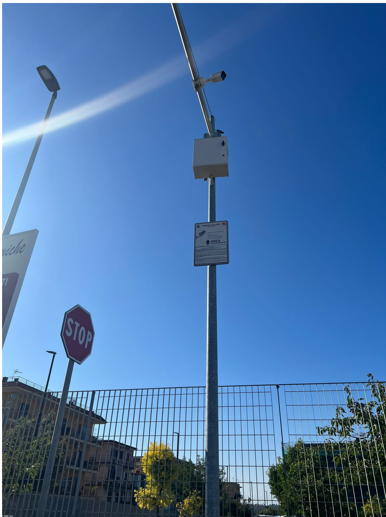
VIA CONSOLARE CAMPANA ( 2 TELECAMERE CONTESTO 1 OCR)
